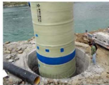
黑臭水体截污泵站
