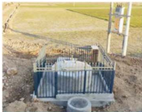
铁路(下穿管道)积淤提升泵站
