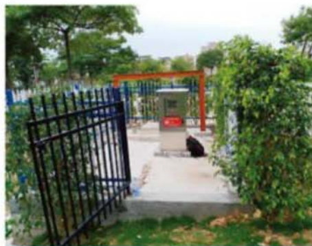
黑臭水体截污泵站
