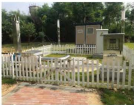
标准竣工泵站
