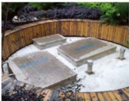
居民区渍水提升泵站
