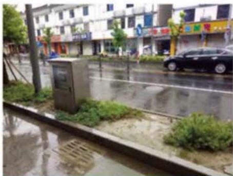
马路下过车泵站
