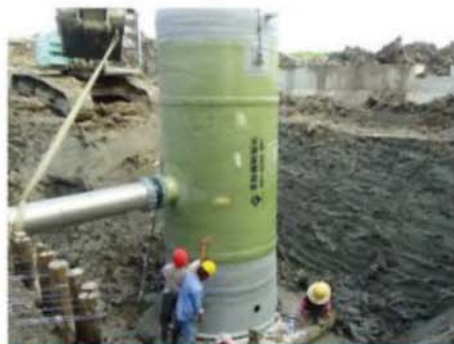
公路(立交桥)积淤提升泵站
