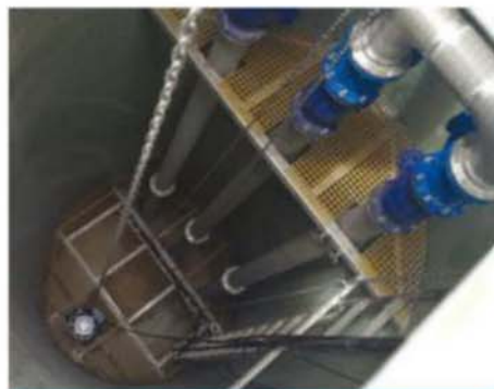
黑臭水体截污泵站
